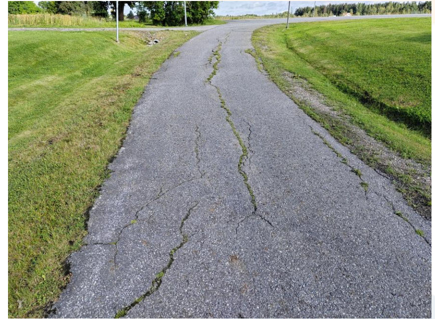
Kuva 15. Vaurioitunut pyörätien päällyste Köpingsissä.
