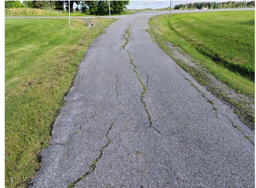
Bild 15. Skadad beläggning på cykelväg i Köpings.
